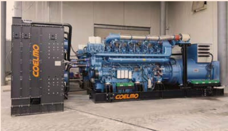
Gruppi Elettrogeni Coelmo da 3.000 kVA per data center
