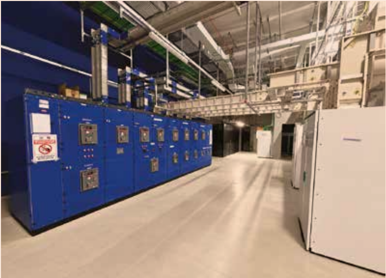
Una cabina elettrica
