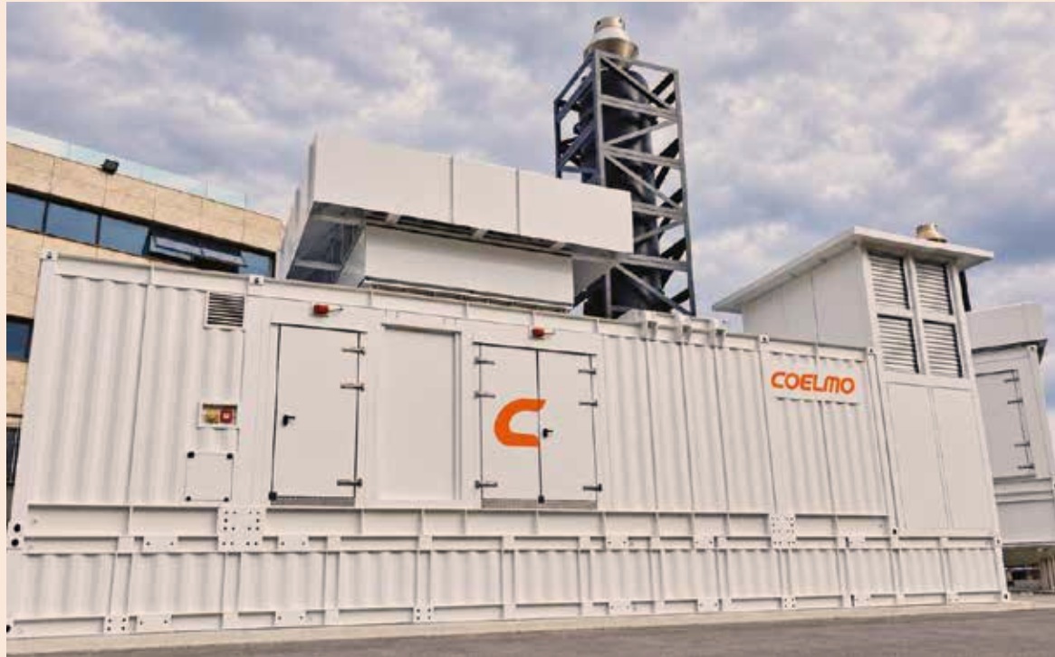
Gruppo Elettrogeno Coelmo da 3750 kVA in container per data center
