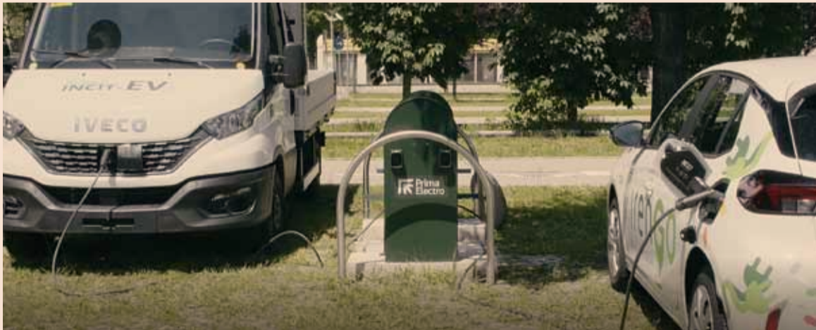
V2V operation: carica di un veicolo e scarica di un altro con i tipici TURET al parcheggio di interscambio di Piazzale Caio Mario
