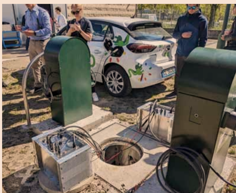
Convertitori per la ricarica DC da 3kW estratti dalla loro sede interrata
